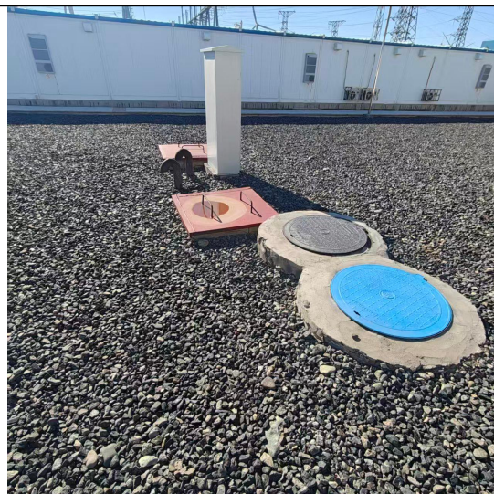
污水一体化处理设施
